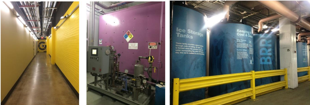
Figure 25. Intérieur du 111 8th avenue. Avec cuve de fioul et stockage thermique. Crédit =©Cécile Diguet et Fanny Lopez, 2018.
